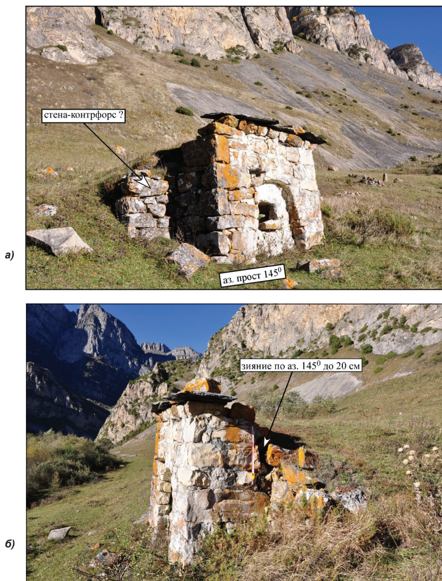
Рис. 15. Деформация «северного» склепа: отрыв стен СВ простираения от фронтальной части:
