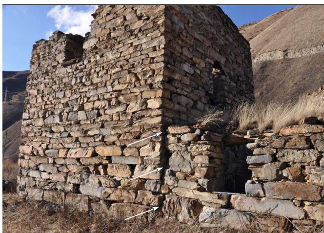
Рис. 10. Наклон и разворот по часовой стрелке южной стены пристройки к Южной (2-й) башне, в связи с этими деформациями между смежными стенами образовался уступ (показан стрелками)
