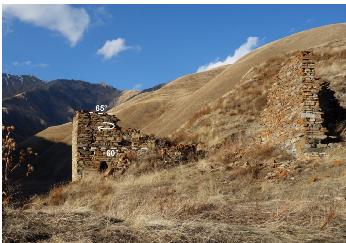
Рис. 17. Обрушение северо-восточной части ганаха (жилища-башни) на северной окраине верхнего квартала Тиба (4 на рис. 13); подписаны азимуты простираения разных фрагментов стены
