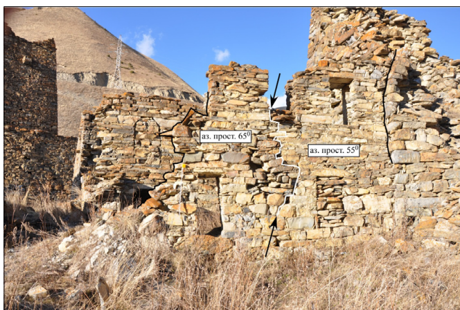
Рис. 9. Деформации южной стены пристройки к Восточной башне, фотография, вид на север (черная ломаная линия слева – край сохранившейся южной стены пристройки; белая ломаная линия в центре и черные стрелки на ее концах – излом в стене, а также ось поворота западной части южной стены по часовой стрелке; черная ломаная линия справа – граница между пристройкой и Восточной башней)
