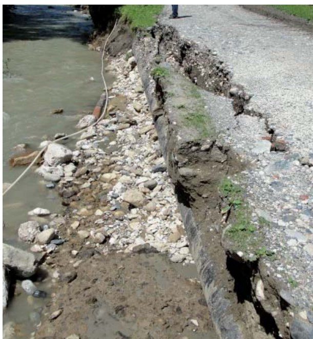
Рис. 8. Деформации левого берега р. Тамискдон, водовода и дороги на территории одноименного курорта после паводка 6 июня 2010 г.
