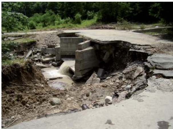
Рис. 4. 9 июня 2010 г. Разрушения на подъездной дороге к монастырю
