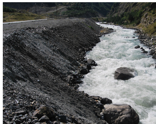
Фото 4. Отвальная площадка выше поселка Бурон, доходящая до уреза воды и никак не укрепленная (фото М.Э. Дзодзиковой)
