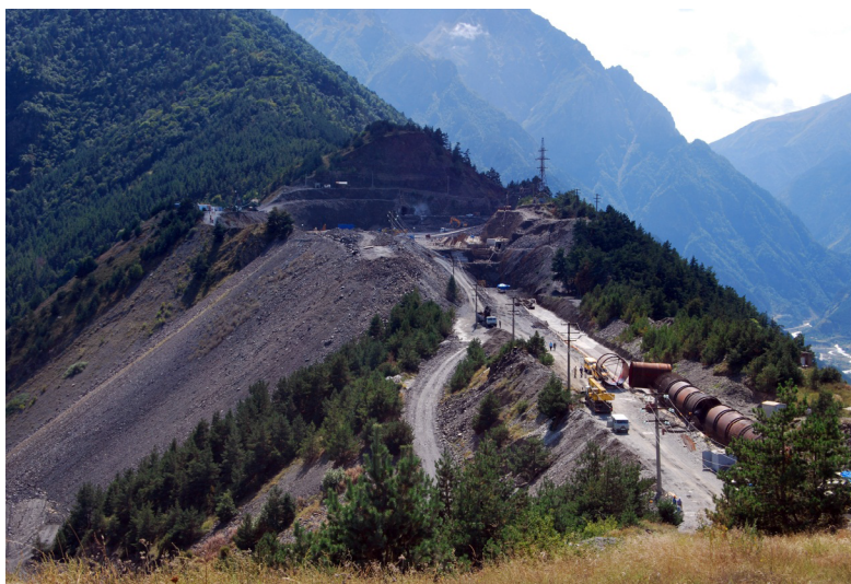
Фото 5. Отвальная площадка к востоку от котлована бассейна суточного регулирования (БСР) Зарамагской ГЭС. (Фото Комарова Ю.Е.)
